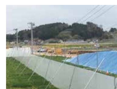
仮囲い鋼板の転倒監視
