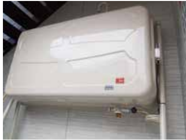
機器設置全景
